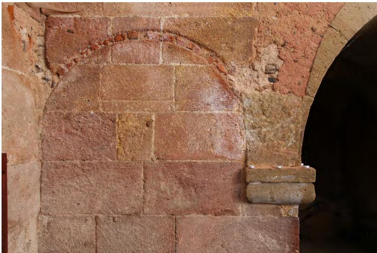
Detail jižní třetiny západní stěny lodi s patrným obloukem pro zavázání čela klenby a odsekaného výběhu meziklenného pasu zaniklé tribuny. Foto: Kateřina Neumannová 2017.
