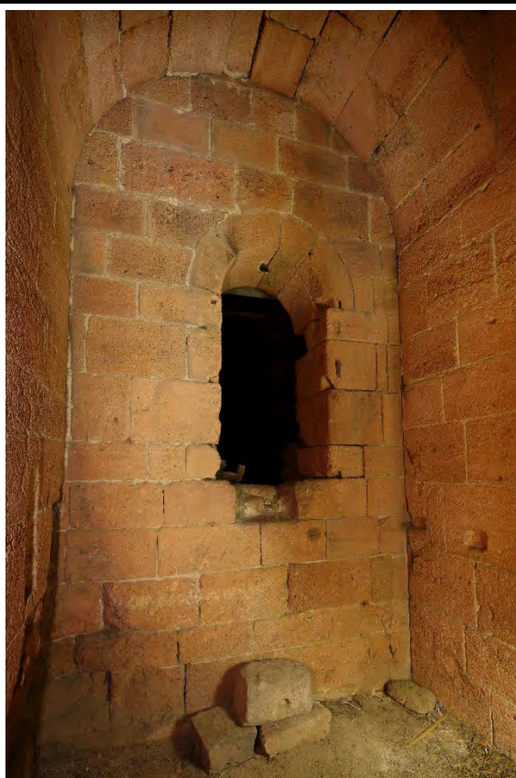
Pohled k východu druhého patra věže. Na snímku je patrný vstup do dnešního podkroví se zazděnou tyčovinou ve vrcholu záklenku. Pod otvorem je deponován kvádr s důlkem. Nad otvorem se nachází klenutý pas vynášející východní zed' věže nad rovinou západního štítu lodi. Foto: Kateřina Neumannová 2017.
