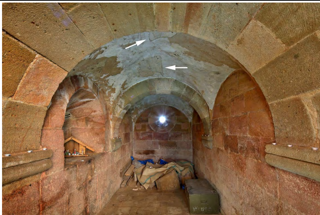
Pohled do podvěží od východu. Šipky označují místa s otisky po prknech šalování. Foto: Kateřina Neumannová 2017.
